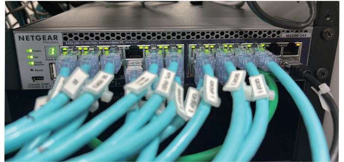
AVシステムの基盤となる NETGEAR「M4300-24X」。大規模映像トラフィックを安定して処理する中核として機能している。
