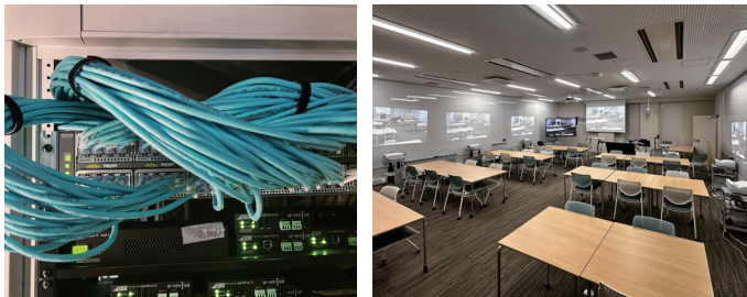
◀バックヤードに設置された NETGEAR「M4300-96X」。大規模な AV 環境を支える中核として機能している。▶小型グループワーク教室。AVoIP を活用し、複数の映像を柔軟に投影できる構成となっている。
